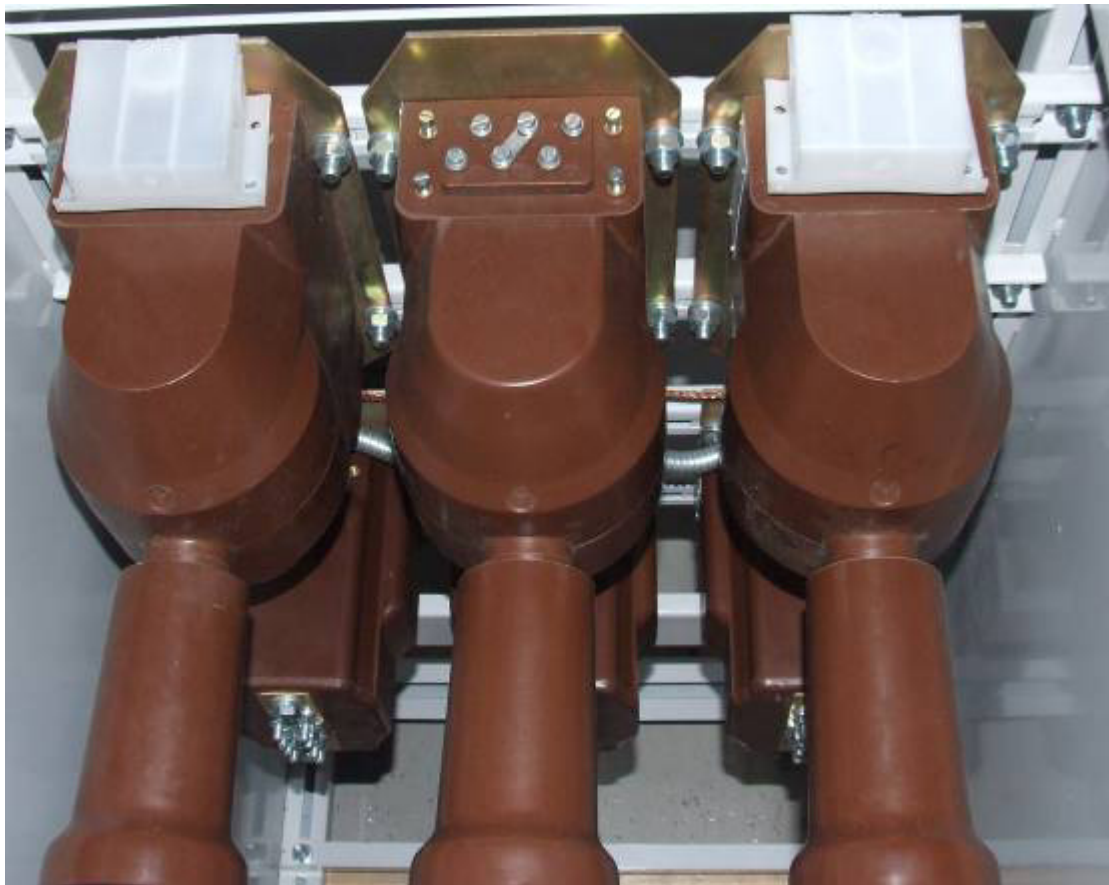
Slika 7. Sekundarni priključci naponskih mernih transformatora
